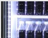
Sistema de iluminación LED
